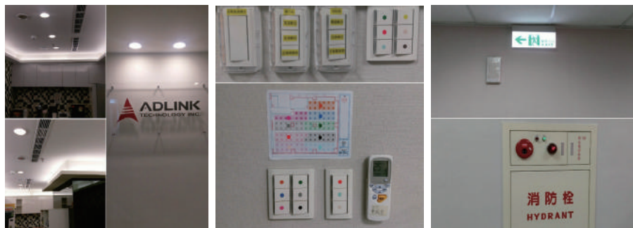
辦公室照明由更換為 LED 及 T5 省電型燈具 消防栓指示燈具更換為省能 LED 燈具 辦公室增設空調及照明總開關及對應控制圖
